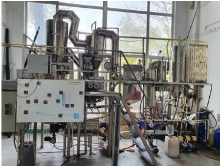
Figura 1. Instalație pilot ASFC cu captare CO 2 post-combustie
