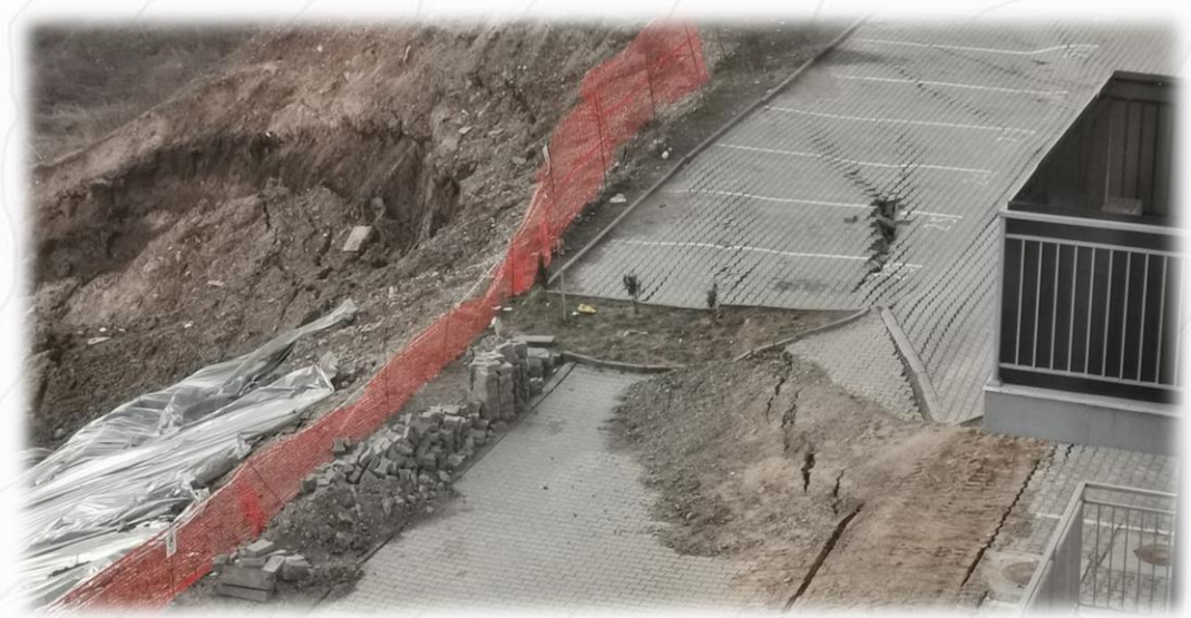
Fig. Alunecări de teren ce afectează infrastructura de locuit, UAT Cluj Napoca , Noiembrie 2020
