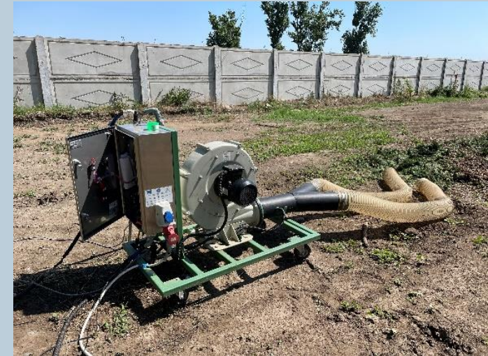
Sistem SCADA, ventilator și racorduri INOVECO
